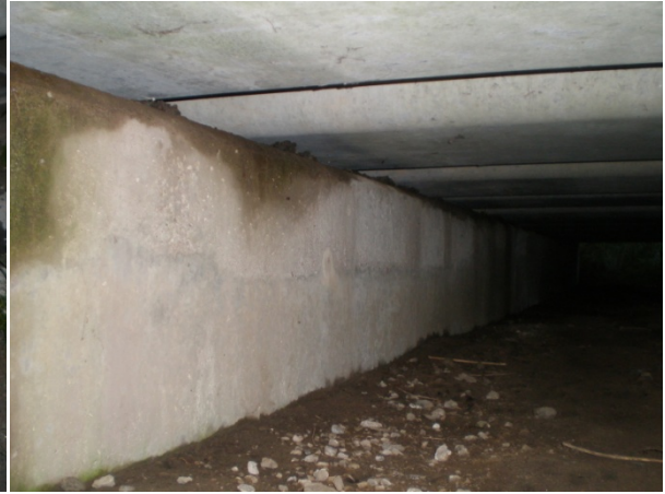
Foto 5.14 Onderzijde voegovergang 3 grotendeels droog
