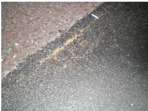
Foto 7.1 Scheur in voegovergang 4
