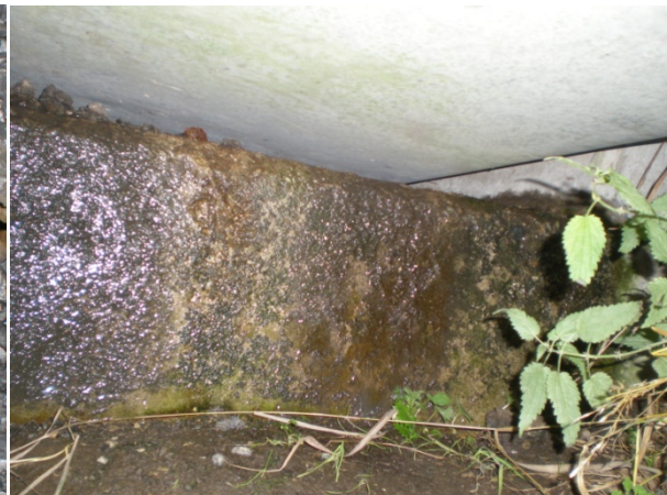
Foto 5.19 Onderzijde voegovergang 4 lekkage waargenomen
