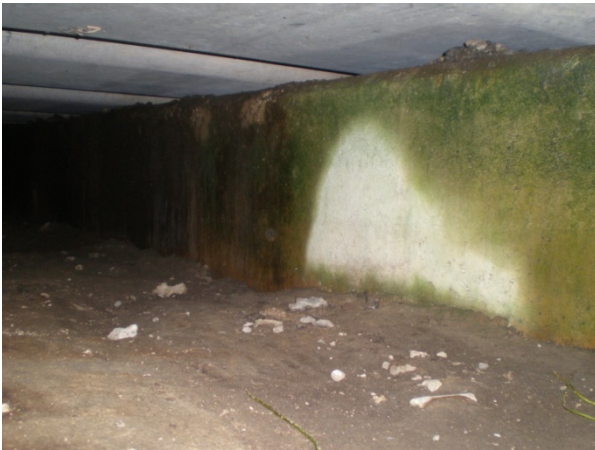
Foto 5.20 Voegovergang 4 lekkage over halve breedte
