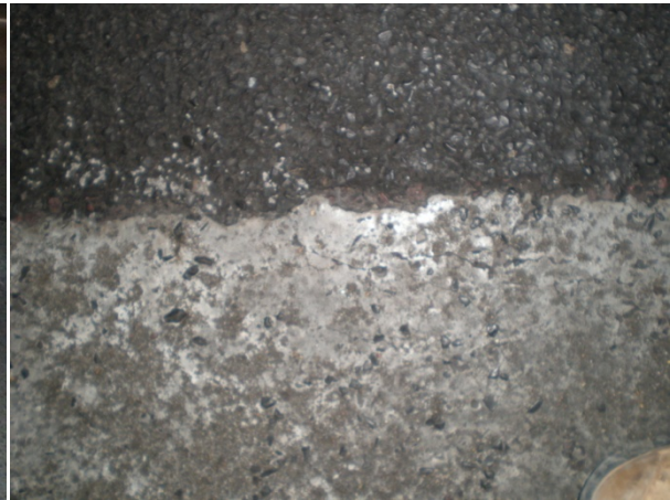
Foto 5.10 Voegflanken lokaal gescheurd
