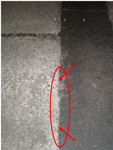
Foto 5.11 Voegflanken lokaal gescheurd in rechterrijspoor
