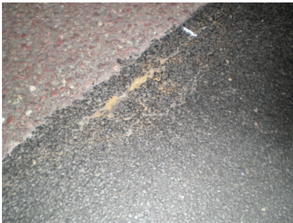
Foto 5.16 schade in voegovergang ter plaatse hoekprofiel
