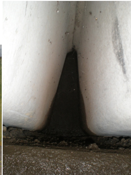
Foto 5.21 Detail tussen 2 balken lekkage
