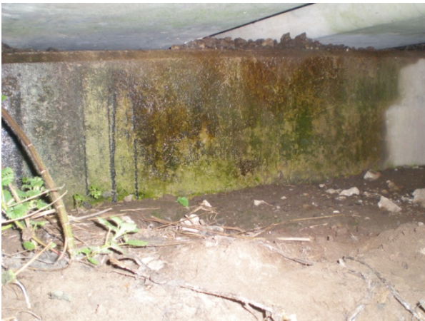
Foto 5.15 Onderzijde voegovergang 3 nat ter plaatse van eerste meter nabij rand kunstwerk
